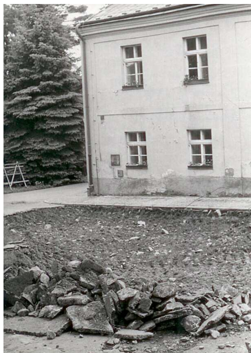
Asfaltová cesta před zámkem byla také poničena.
